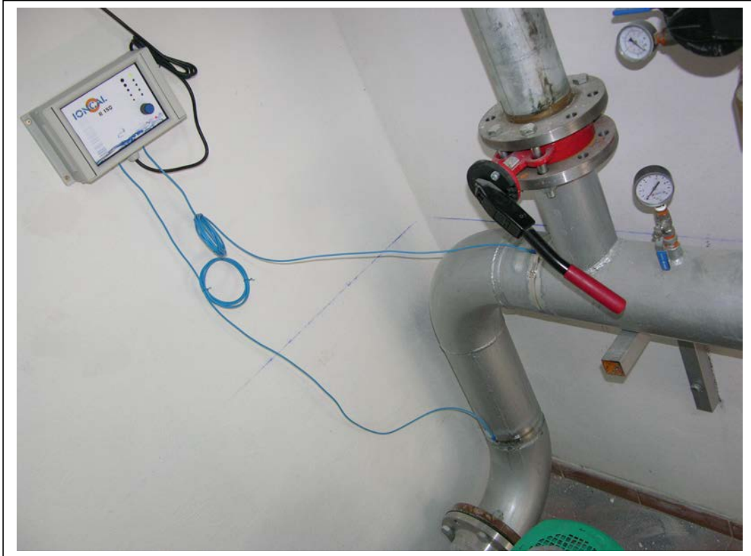
Hotel Flaminio, Urb. Valle Romano, Estepona, Málaga, Marzo 2012 Unidad de control Anti-incrustante por ultrasonidos IONCAL E-150 Instalado en salida de colector grupos de presión, de Acero de 163 mm
