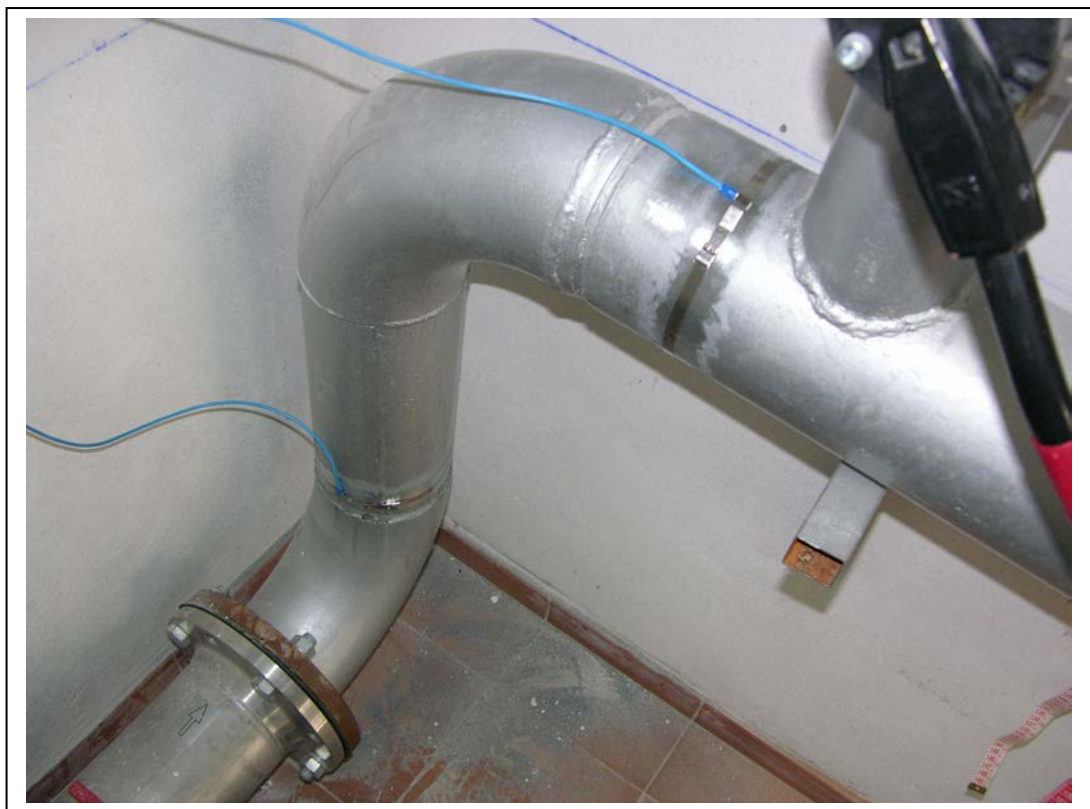
Hotel Flaminio, Urb. Valle Romano, Estepona, Málaga, Marzo 2012 Unidad de control Anti-incrustante por ultrasonidos IONCAL E-150 Instalado en salida de colector grupos de presión, de Acero de 163 mm
