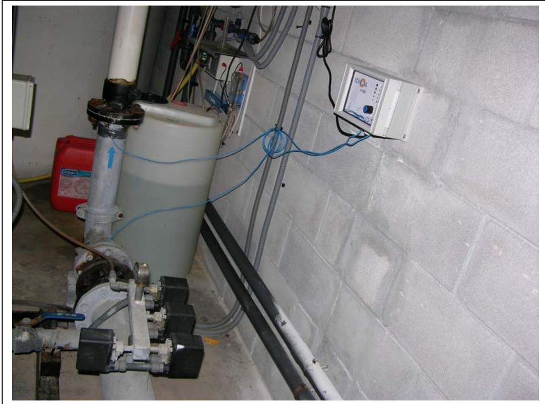
Hotel Guadalpin Nueva Andalucía, Marbella, Málaga, Agosto 2012 Unidad de control Anti-incrustante por ultrasonidos IONCAL E-125 Instalado en salida de colector grupos de presión, de Acero de 125 mm
