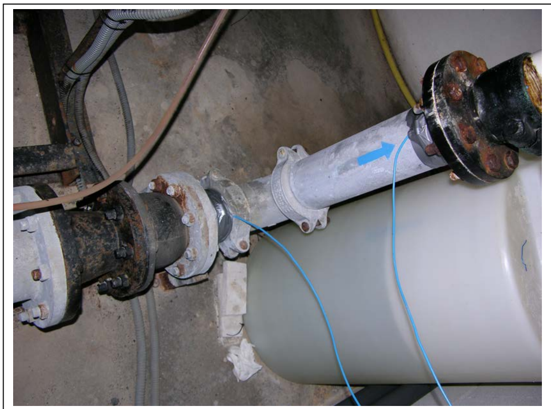
Hotel Guadalpin Nueva Andalucía, Marbella, Málaga, Agosto 2012 Unidad de control Anti-incrustante por ultrasonidos IONCAL E-125 Instalado en salida de colector grupos de presión, de Acero de 125 mm
