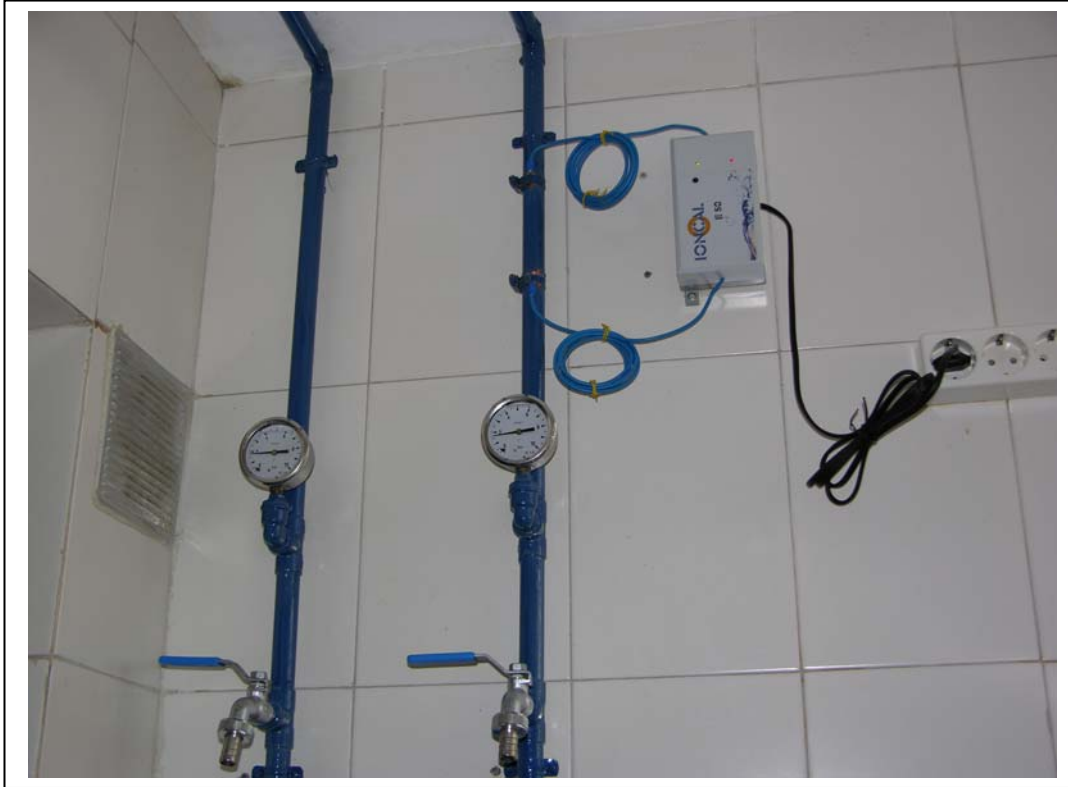
C/ Maestro Tomas Bretón, Urbanización Heliomar. Málaga. Noviembre 2006 Detalle de Anti-incrustante IONCAL E-50 montado sobre tubería de Ø 22 mm de cobre de Bypass de entrada de agua a consumo.
