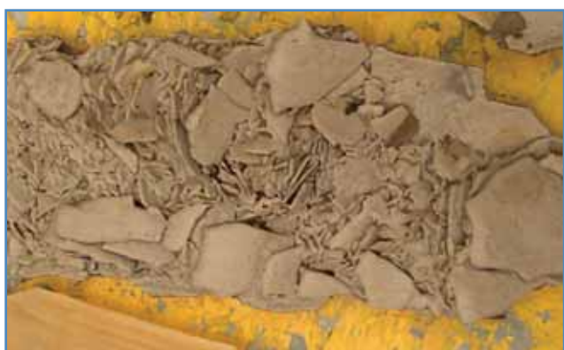
Restes d'incrustations de calcaire d'une tuyauterie qui n'a pas été traitée avec ioncal.
